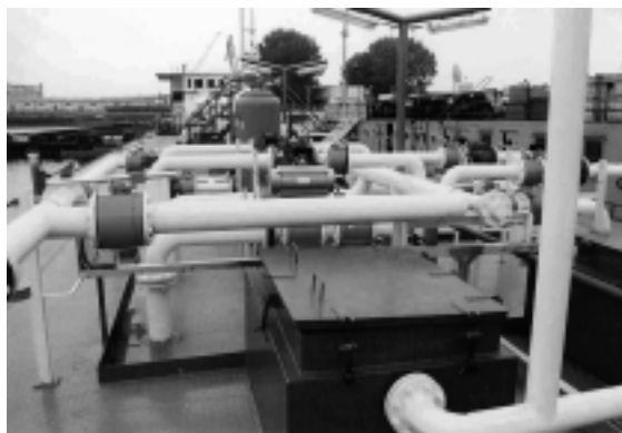
Obr. 8 Plniace a výdajné potrubie Fig. 8 Filling and issuing pipes
